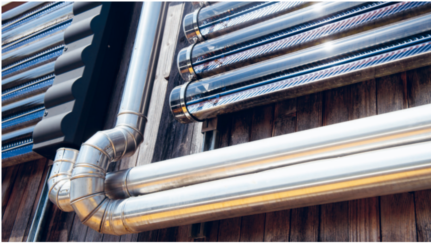
Die Solarthermie-Röhrenkollektoren an der Fassade des Einfamilienhauses in Villars-sur-Glâne (FR) liefern Energie für Raumwärme und Warmwasser.
