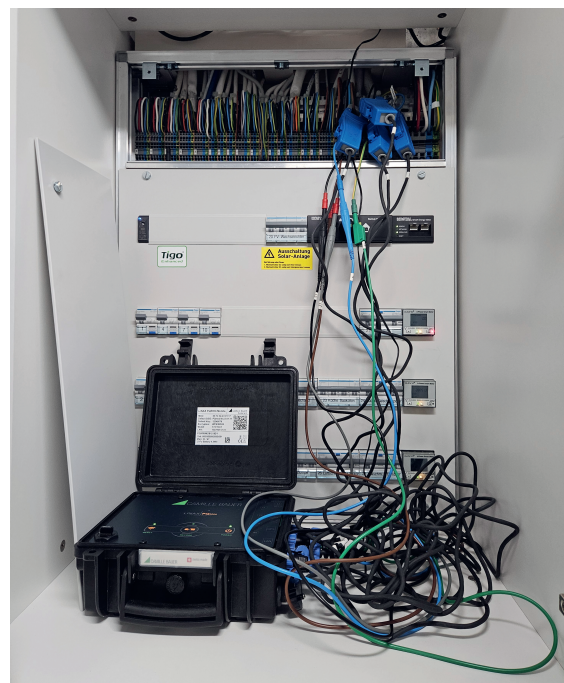
Bild 1 PQ-Messung am Anschlusspunkt einer Anlage.
