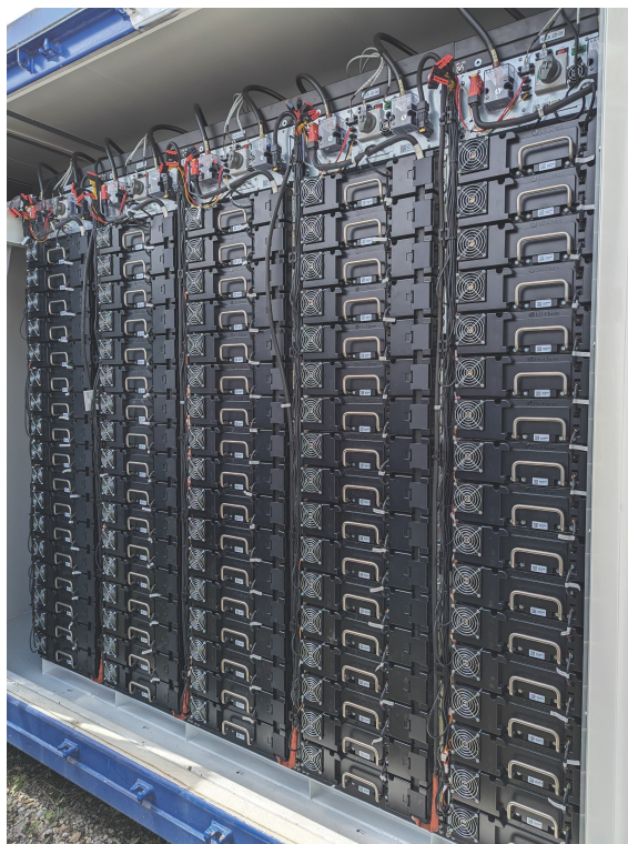
Bild 1 In den Containern von Ingenbohl sind tausende individuelle Batteriezellen in jeweils knapp sechshundert Einschubmodulen installiert.
