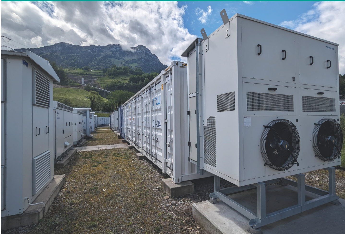
Batteriespeicher beim CKW-Unterwerk in Ingenbohl, Schwyz.
