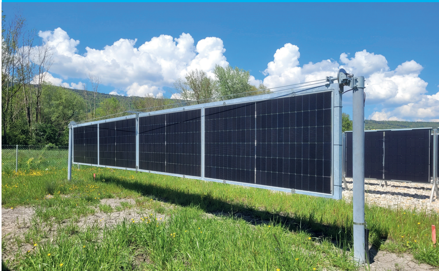
Démonstrateur de PV bifacial vertical balançant avec haubanage.
