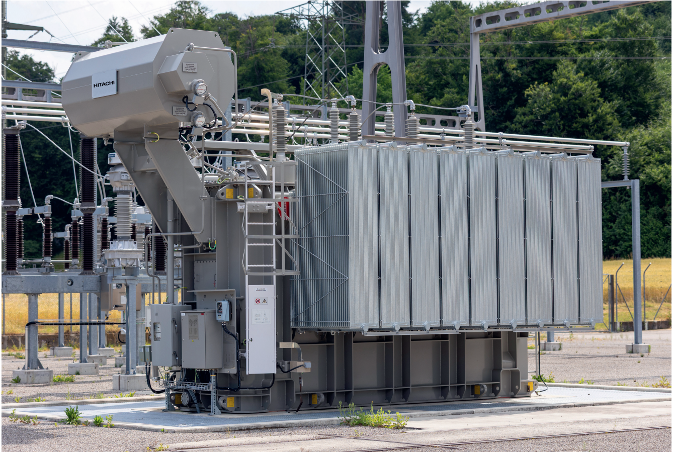
Réactance shunt 50 Mvar, 66 kV, sur le réseau de Groupe E, à Monteynan.
