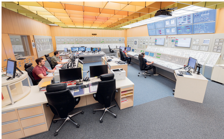
Steuerzentrale des KKW Gösgen.
