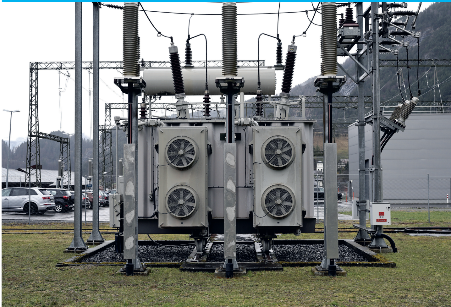
Hochspannungs-Transformator in Innertkirchen.
