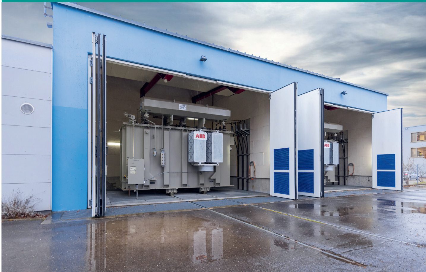
HS/MS-Transformatoren (25 MVA) mit dynamischer Regelung der Sekundärspannung.
