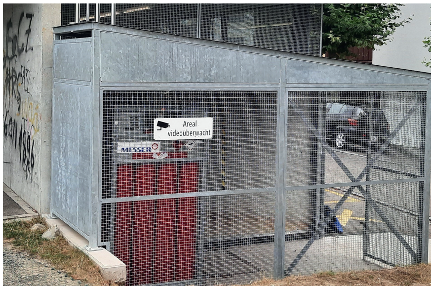
Bild 3 Aufstellung Wasserstoffzylinder zur Notstromversorgung.
