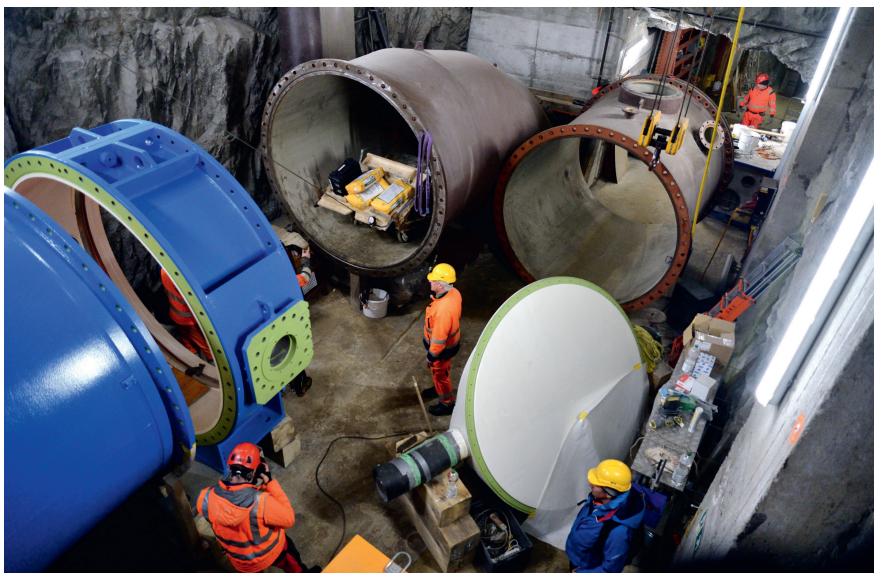
Bild 4 Apparatekammer mit demontierter Drosselklappe und Druckschacht. Der Vermessungswagen im Druckschacht wird mit einer Seilwinde heruntergelassen.
