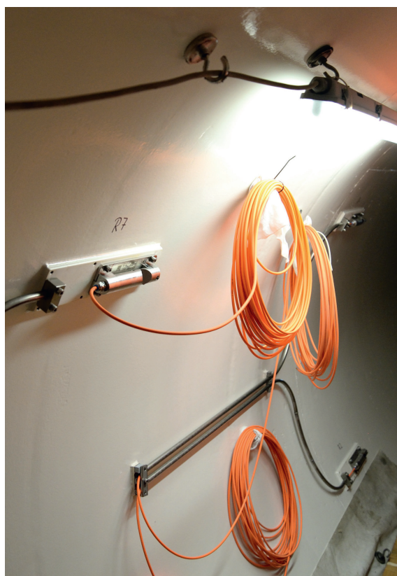
Bild 5 Die neuen Sensoren für die Durchflussmessung.
