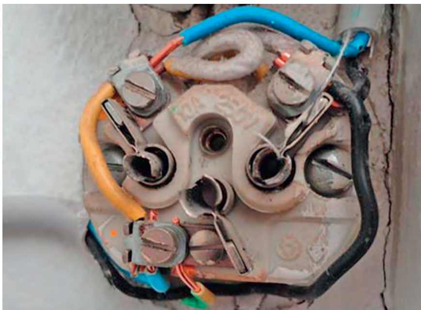
Bild 3 AP-Steckdose mit eingelegeter «Nullungsbrücke».
