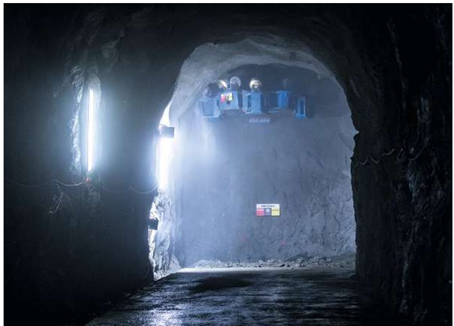
La tête de forage est prête pour creuser un puits dans la roche de bas en haut.
