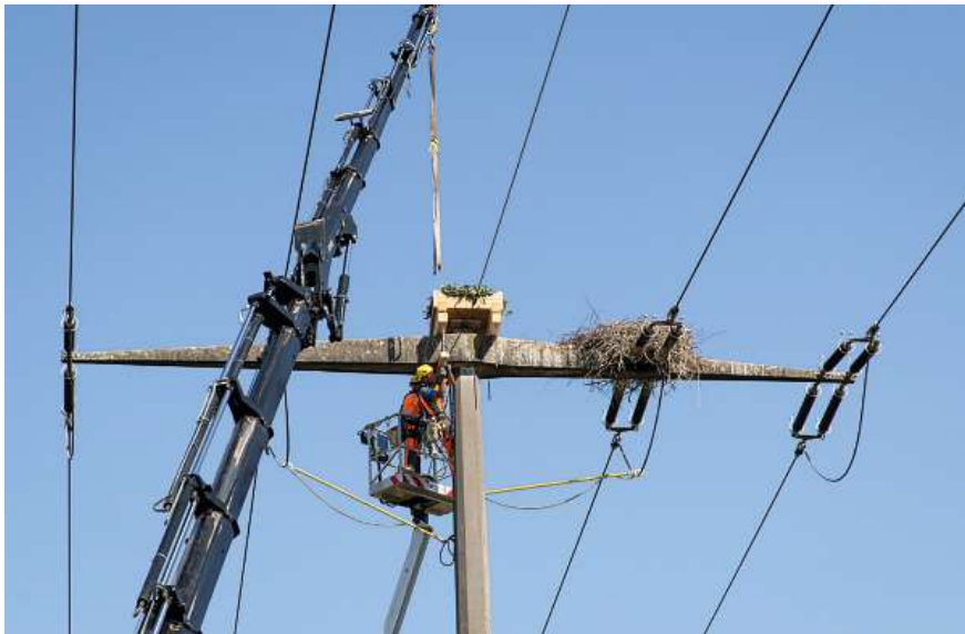
Freileitungsmonteure von Axpo errichten ein neues, stromschlagsicheres Nest für die jungen Weissstörche. Rechts daneben befindet sich das später entfernte Nest in gefährlicher Lage bei den Abspannisolatoren.
