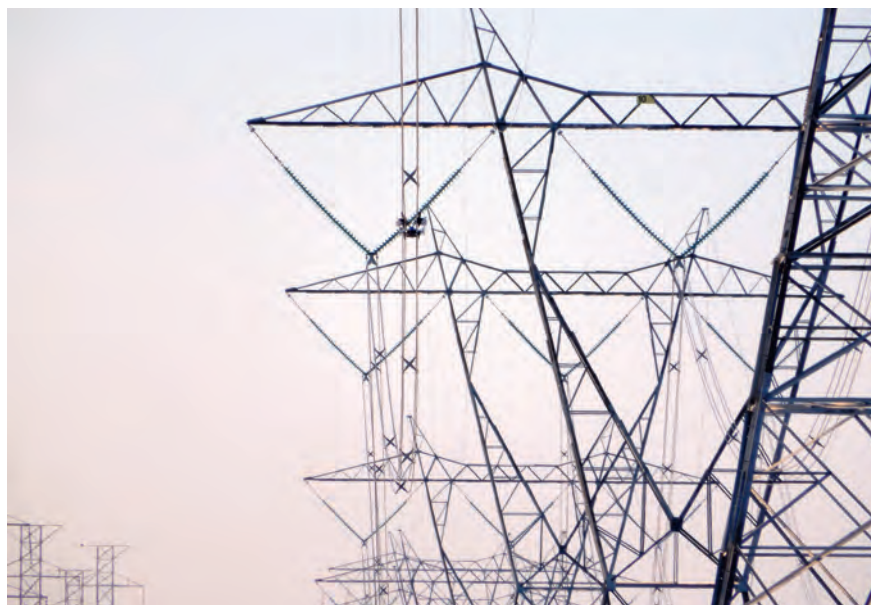
Figure 2 Les faisceaux de conducteurs : un défi pour l'inspection par robot roulant, vu la fréquence des composants à franchir.
