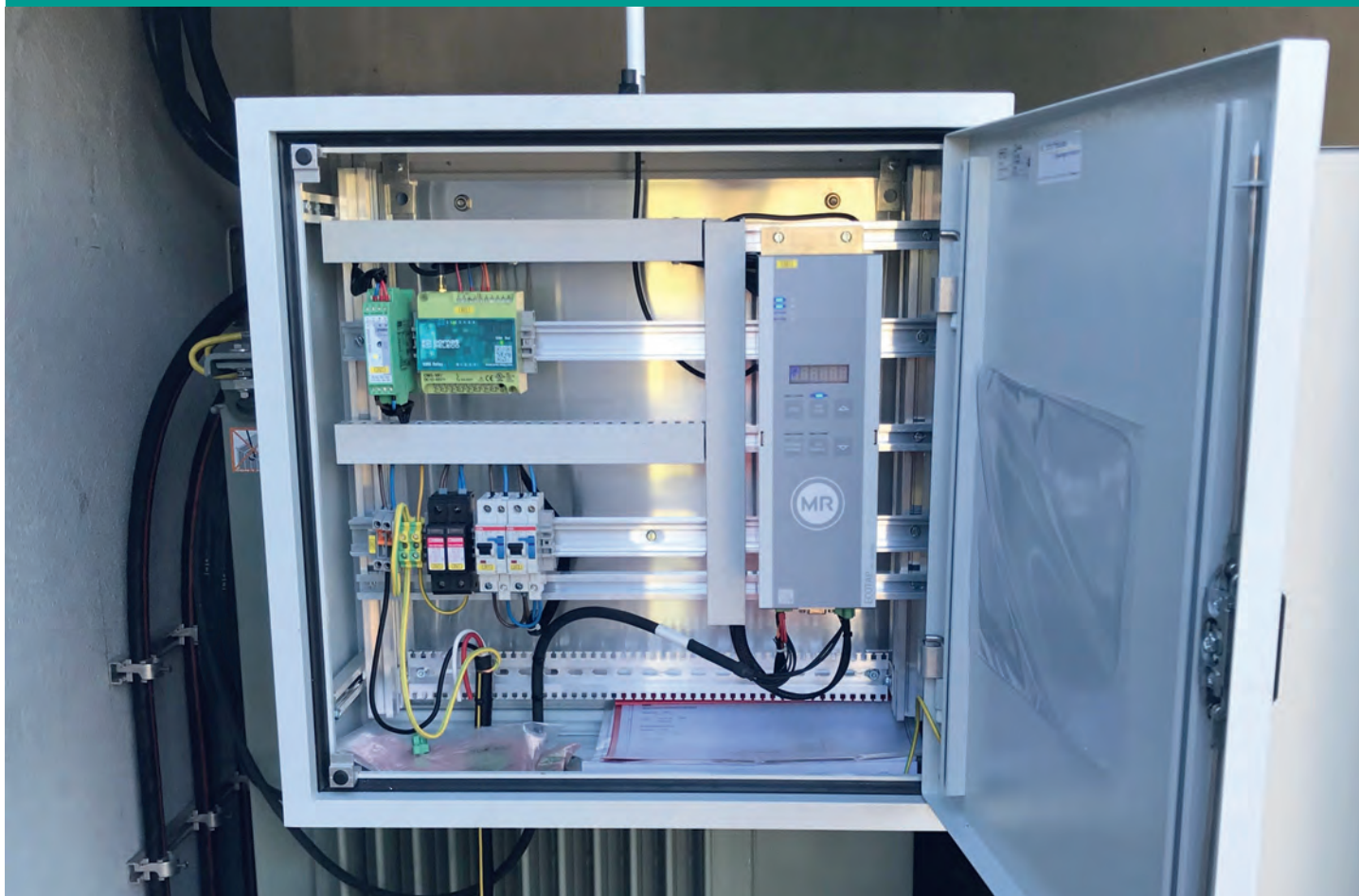
Steuerung eines regelbaren Ortsnetztrafos.
