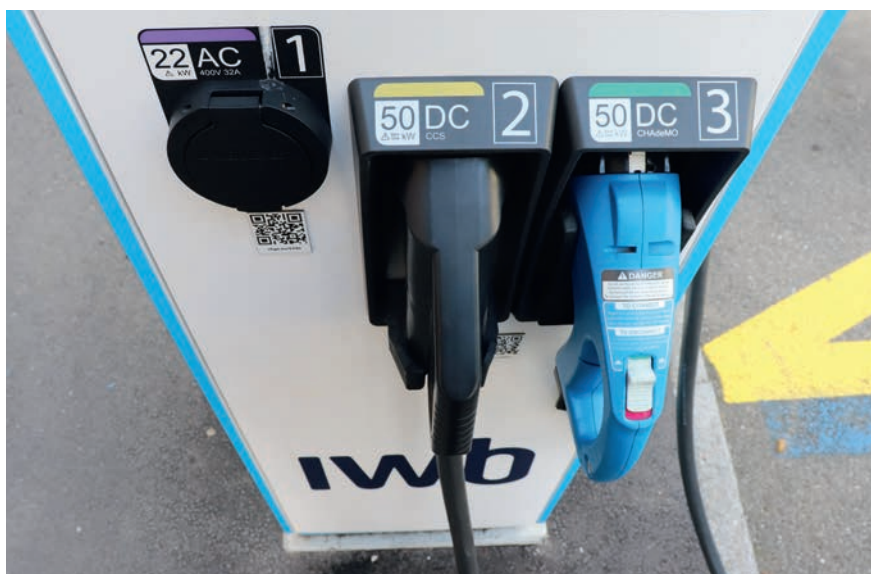
Figure 1 Cette borne dispose de trois points de recharge: à gauche, la prise d'une puissance de 22 kW et, à droite, deux connecteurs d'une puissance de 50 kW chacun.
