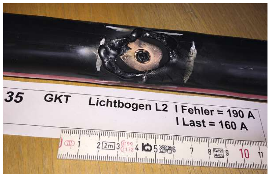
Bild 3 Fehlerstelle eines durch den Erdschluss beschädigten Versuchskabels.
