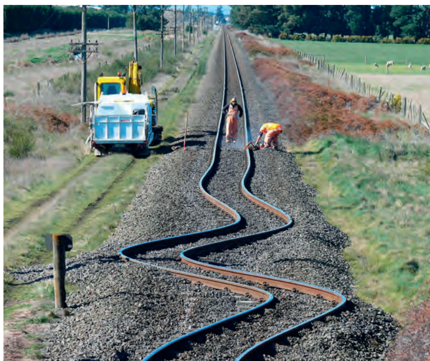
Figure 7 Que cela soit dû à des phénomènes sismiques ou à la dilatation sous l'effet de la chaleur, les rails peuvent subir des déformations parfois spectaculaires.
