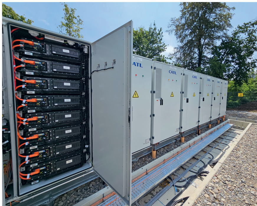
Das System mit einer Speicherkapazität von 10 MWh baut auf der Cube-Technologie auf.
