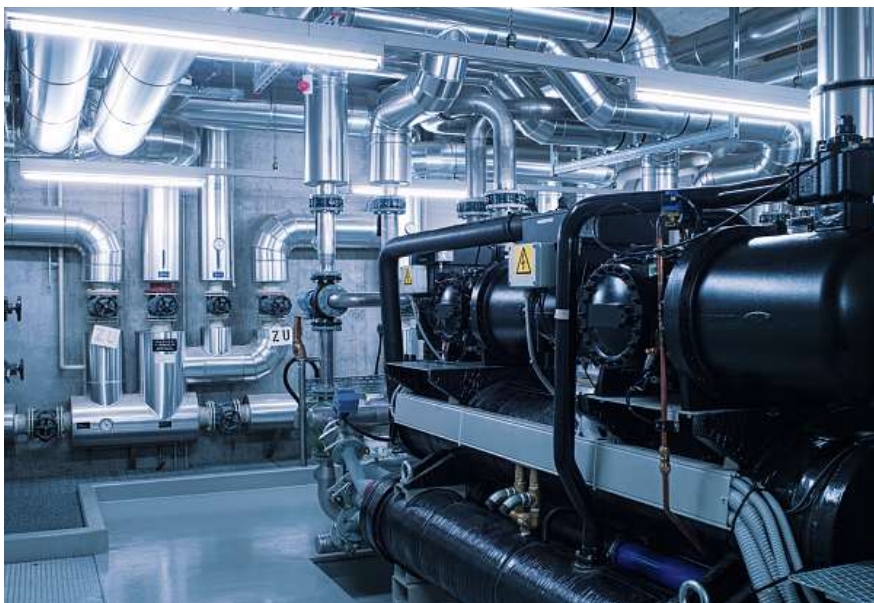
Ein Blick in die Kühleinheit des Rechenzentrums.
