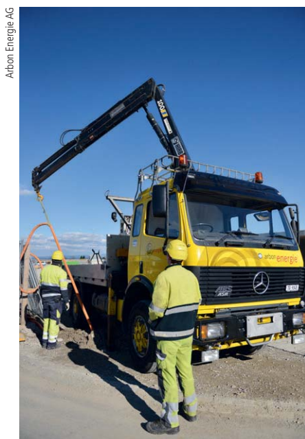
Figure 7 Le fournisseur d'énergie de Thurgovie Arbon Energie AG exploite, outre un réseau électrique, aussi un réseau de fibres optiques.
